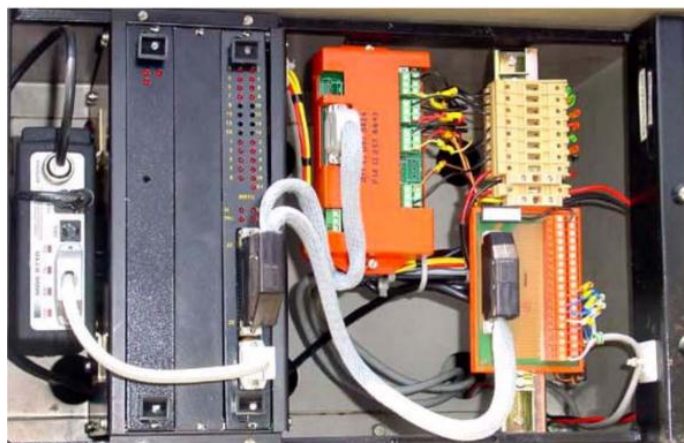
شکل ۷-۷ تجهیزات داخلی یک MRTU
