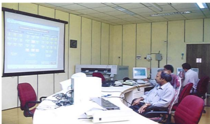
شکل ۵-۷ اتاق کنترل سیستم کنترل مرکزی
